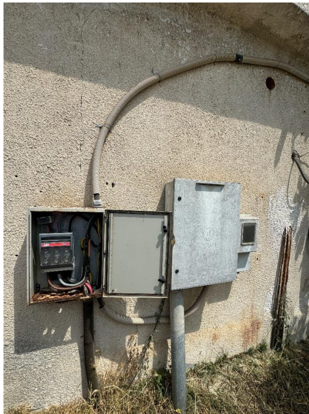
Εικόνα 2.4.3 Γενικός διακόπτης υφιστάμενης παροχής χαμηλής τάσης
