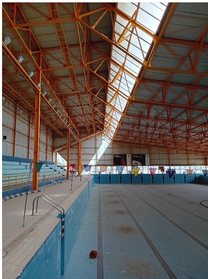
Εικόνα 2.4.1 Υφιστάμενη κατάσταση φωτισμού μεγάλης πισίνας προβολείς σε ύψος 8 m από το έδαφος
