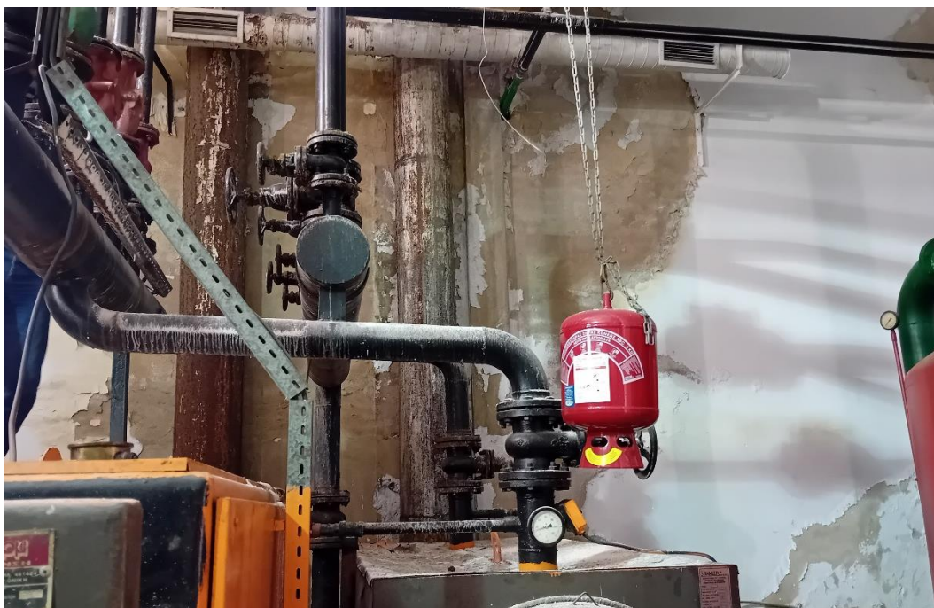
Εικόνες 2.4.7 Υφιστάμενοι Λέβητες Θερμού Νερού
