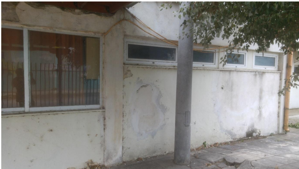
Εικόνα 3.4.1 Επιφάνειες που απαιτούν αποκατάσταση επιχρισμάτων και σκυροδέματος 1/2
