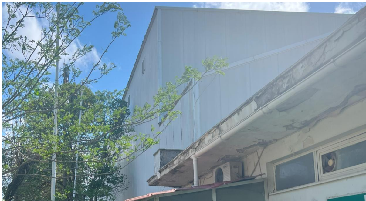
Εικόνα 3.4.2 Επιφάνειες που απαιτούν αποκατάσταση επιχρισμάτων και σκυροδέματος 2/2
